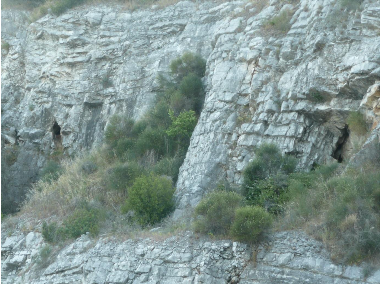
Photo 3 : aperçu des fissures présentes au niveau des fronts de l'ancienne carrière
